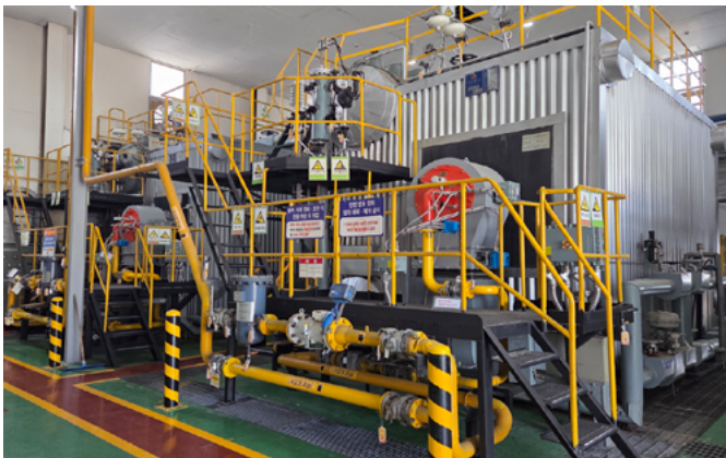
| 보일러 초저녹스 버너 설치(세종사업장)
